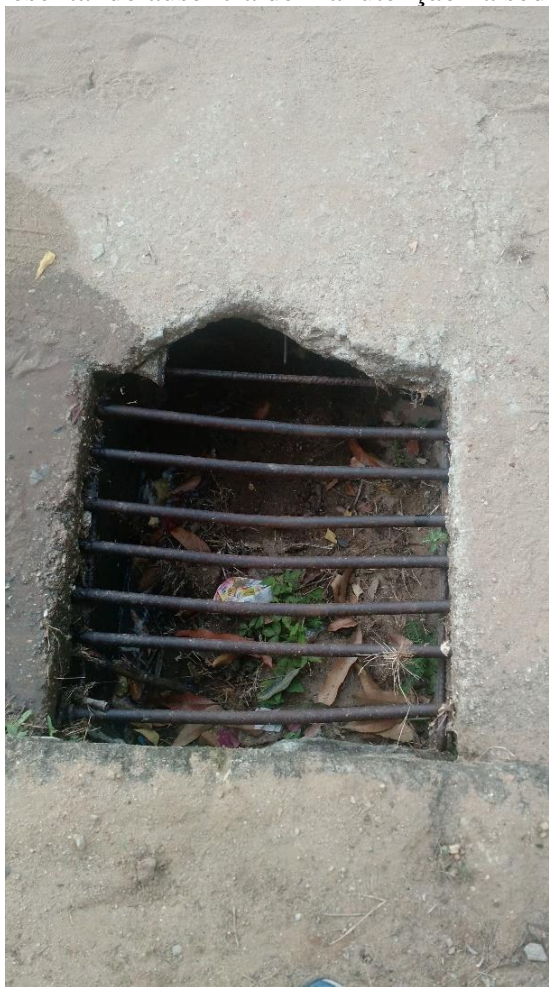
Figura 10 - Bueiros apresentando ausência de manutenção na sede do município de Itinga
