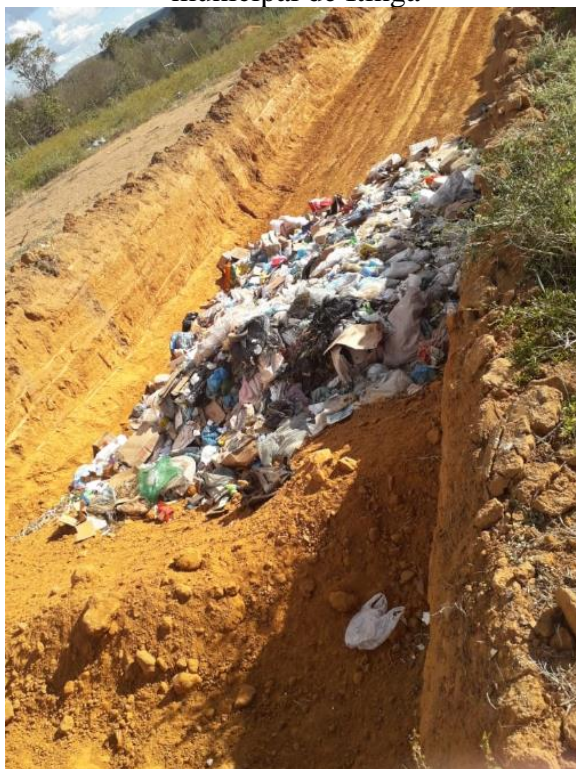
Figura 6 - Abertura de nova vala para recobrimento de resíduos no aterro controlado municipal de Itinga
