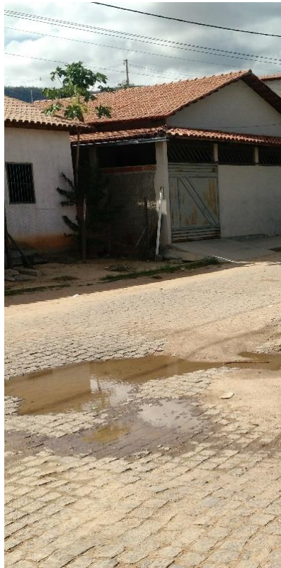
Figura 9 - Pontos com presença de água na Rua Almenara no bairro Porto Alegre em decorrência da insuficiência de bueiros
